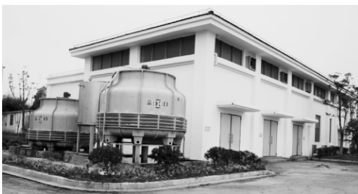
图 3 南泉水源厂预处理臭氧发生器冷却塔
